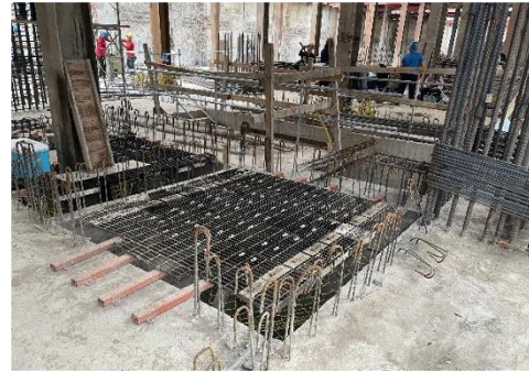
ABC棟 B2FL電梯開口隔柵 太穩5/8
